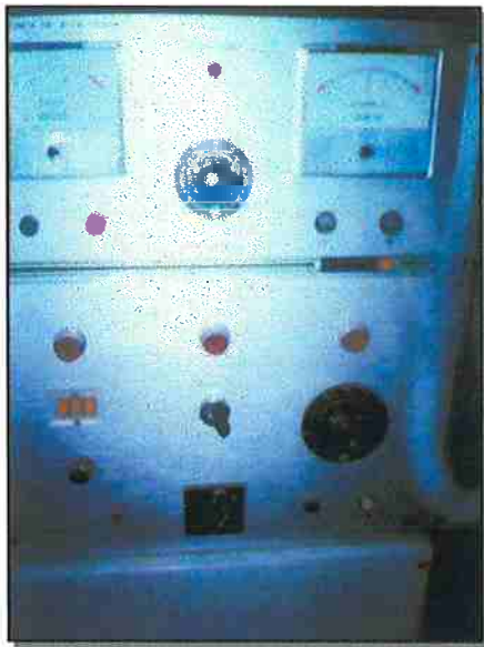
Figura23 - Fonte de alta tensão e controles de alimentação, rotação do tambor e potencial
